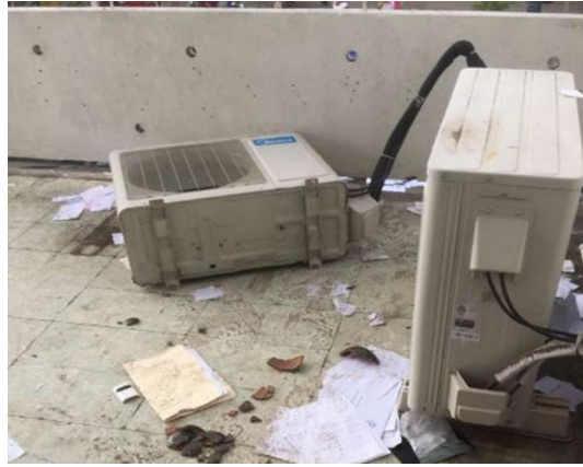
Figura 5 Malas prácticas de manejo de los equipos de aire acondicionado
