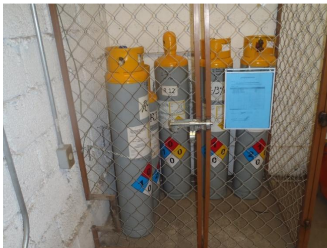
Figura 10 Tanques de gas refrigerante almacenados en el centro gestor de equipos
